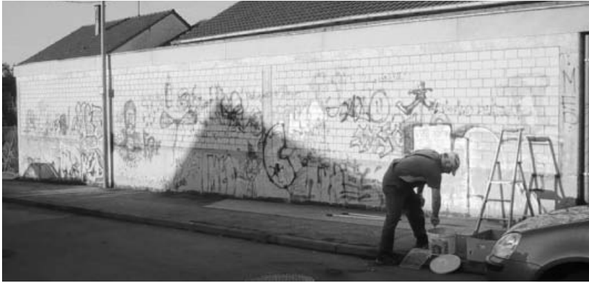
Über 190 Schmierereien haben die drei Stadtstreicher seit der Gründung der Initiative beseitigt - hier bei der Arbeit in Kleinsachsenheim. Ausdauer und die finanzielle Unterstützung durch die Stadt haben zu dem Erfolg beigetragen.
