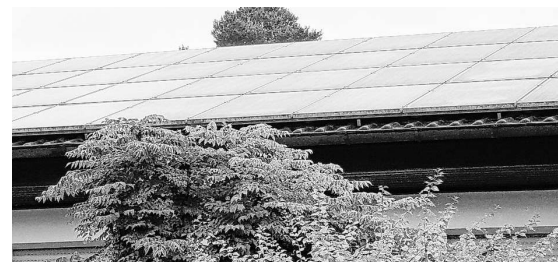
Solarzellen liefern bei Stromausfall nur Strom, wenn die Technik dahinter auch ohne öffentliches Stromnetz funktioniert.
